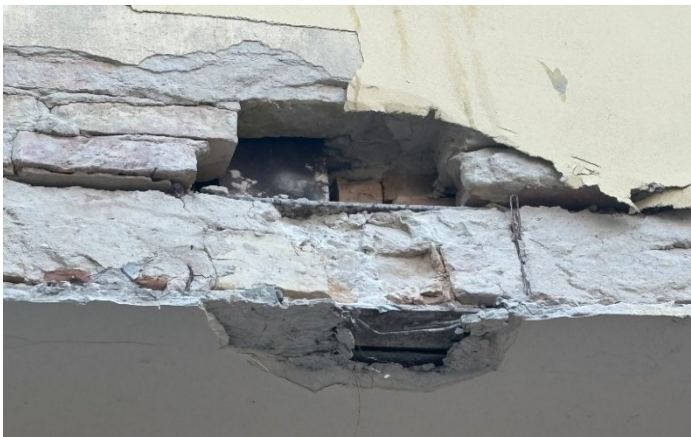
Schadenbegutachtung nach Anprall eines LKW
